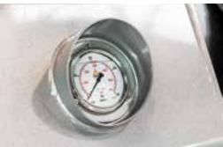
Manometer zur Kontrolle des Betriebsdrucks
