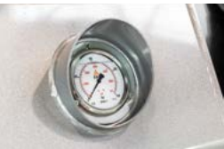
Manometer zur Kontrolle des Betriebsdrucks
