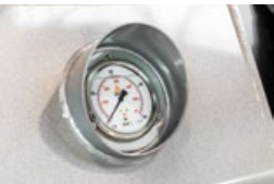
Manometer zur Kontrolle des Betriebsdrucks
